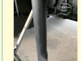
ドレンホース
