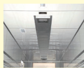
天井露出ダクト+結露防止
